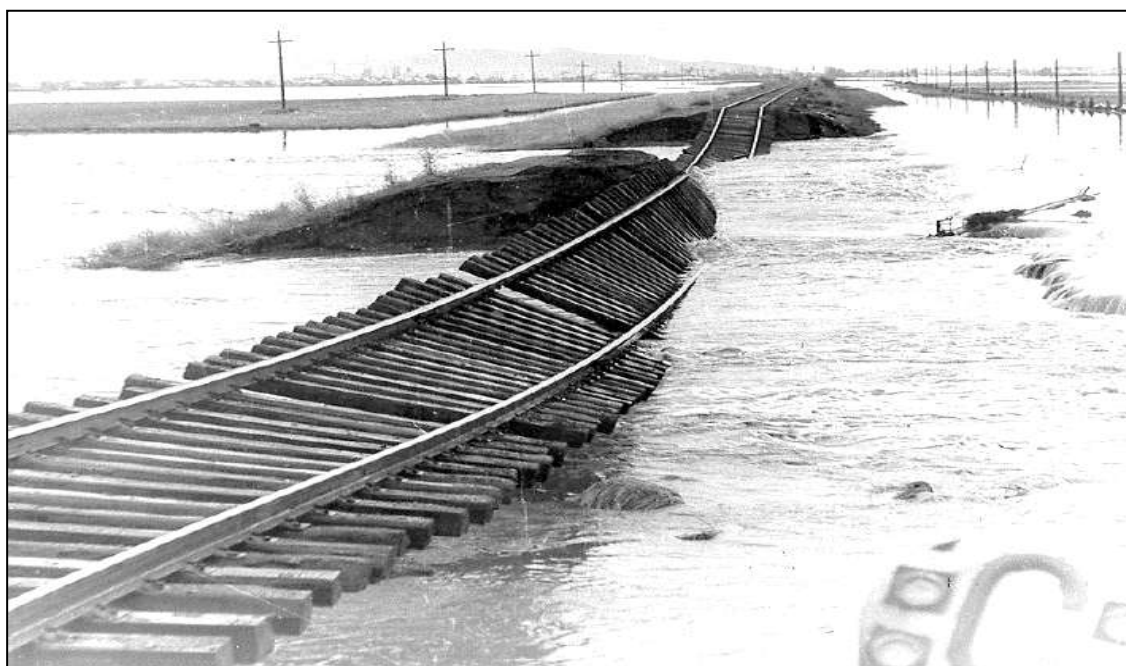
Рис. 1. Размыв железнодорожного пути на перегоне
